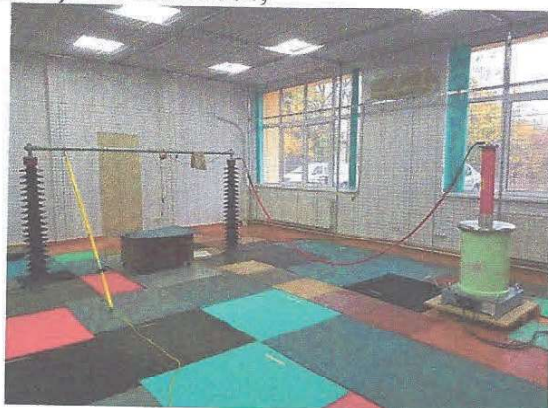
Fig.9 Standul de încercări cu tensiune mărită
